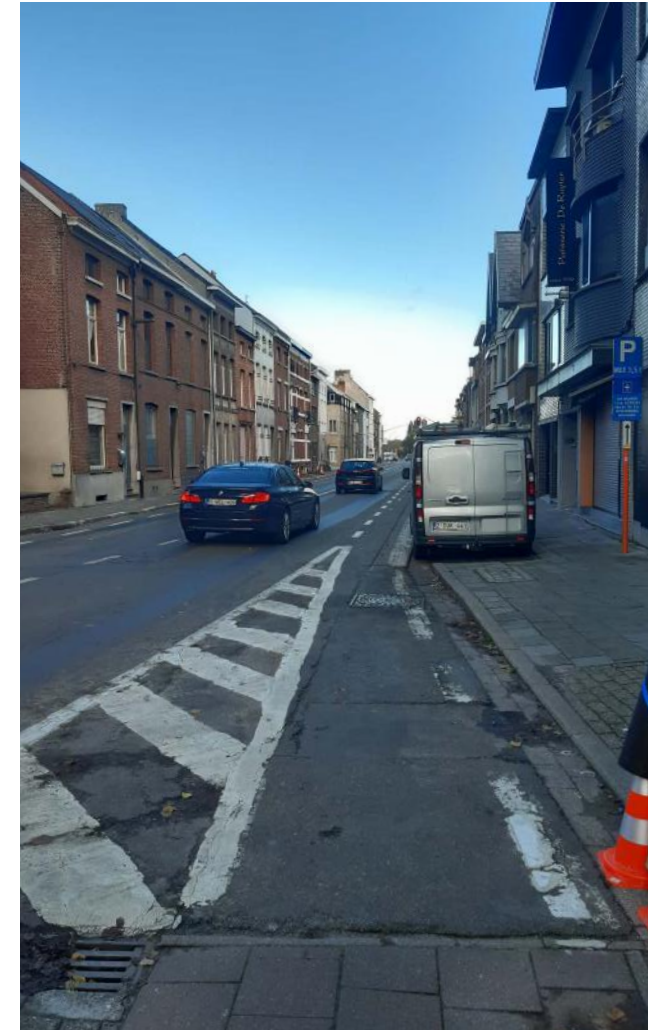
Fietspaden in slechte staat op delen van de Liersesteenweg
